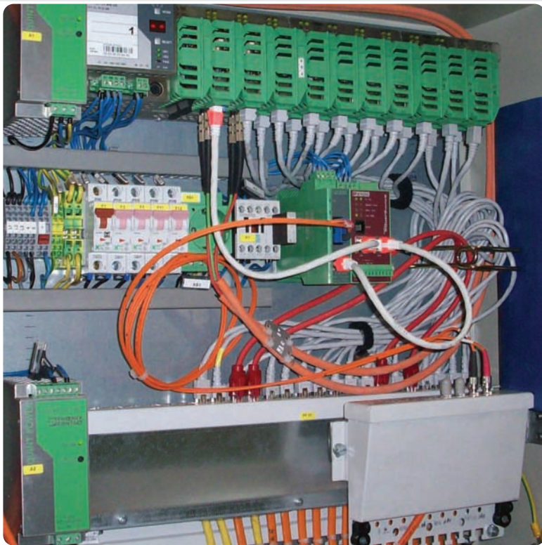
Bild 2: Sensible Produktionsanlagen sind meistens nicht ausreichend geschützt. Eingeschleppte Schadprogramme oder auch unbeabsichtigte Fehleingaben im internen Netz können durch zentrale Firewalls nicht verhindert werden.
